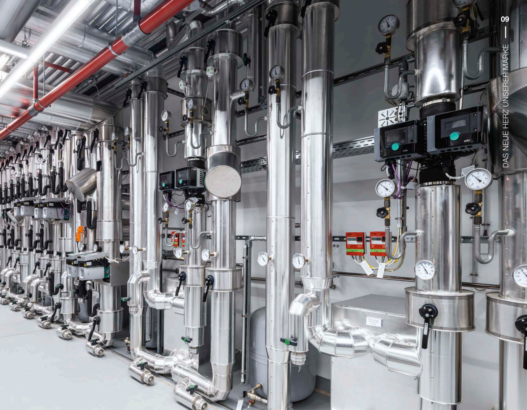
Effizienz zum Anfassen: die Technikzentrale der Viega World
