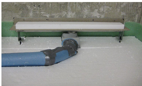
Abb. 278: Die Anschlussleitung zu dämmen kann eine wichtige Maßnahme sein, gerade wenn es um die Einhaltung des erhöhten Schallschutzes geht.
