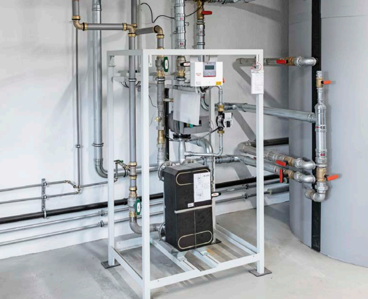
Trinkwasser-, Heizungs- und Betriebswässer-Installationen in unmittelbarer Nachbarschaft – und alle aus dem Viega Systemverbund: Blick in eine der Wärmezentralen des Neubaus.
