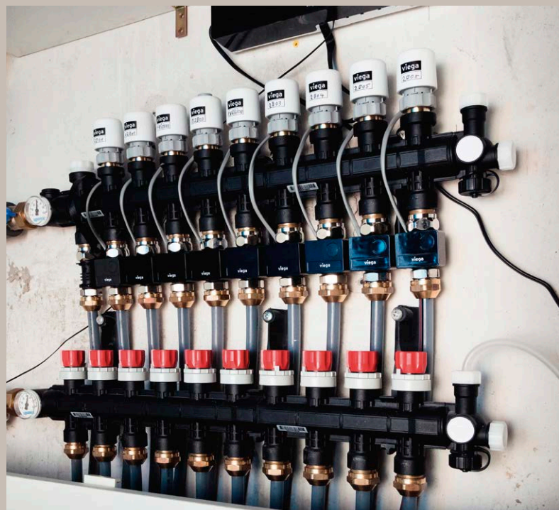
So einfach lässt sich ein automatischer hydraulischer Abgleich im Bestand selbst bei Fremdverteilern installieren: Hier wurden in einer Wohnanlage insgesamt fast 20 solcher Heizkreisverteiler mit Fonterra Smart Control ausgestattet.
